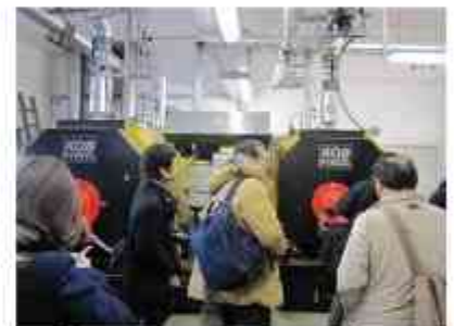
図3 宿泊したホテルのチップボイラー
