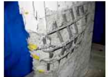
図2 最終破壊状況 (H2)
