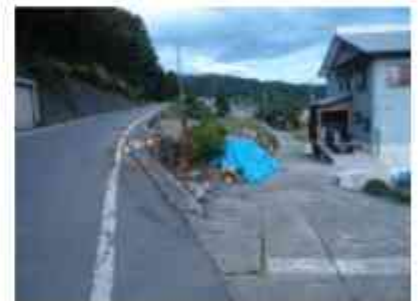
図2 崩れ落ちた法面
