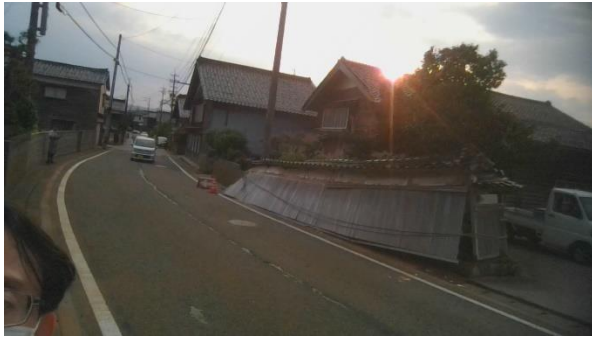
木造の塀の破損 (37.4421205, 137.2807949)
